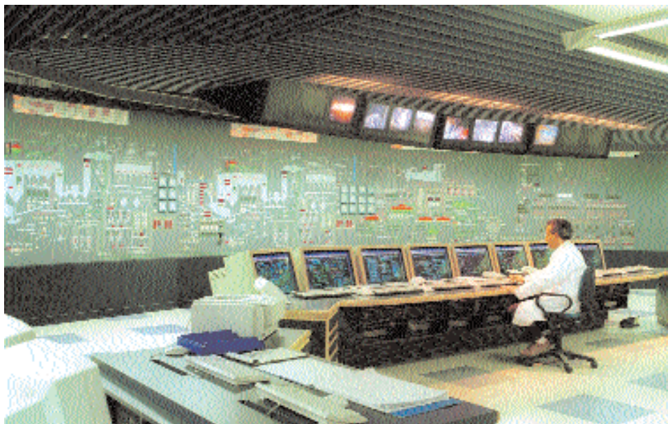
Fig. 6. TU di Brescia: sala di controllo.
